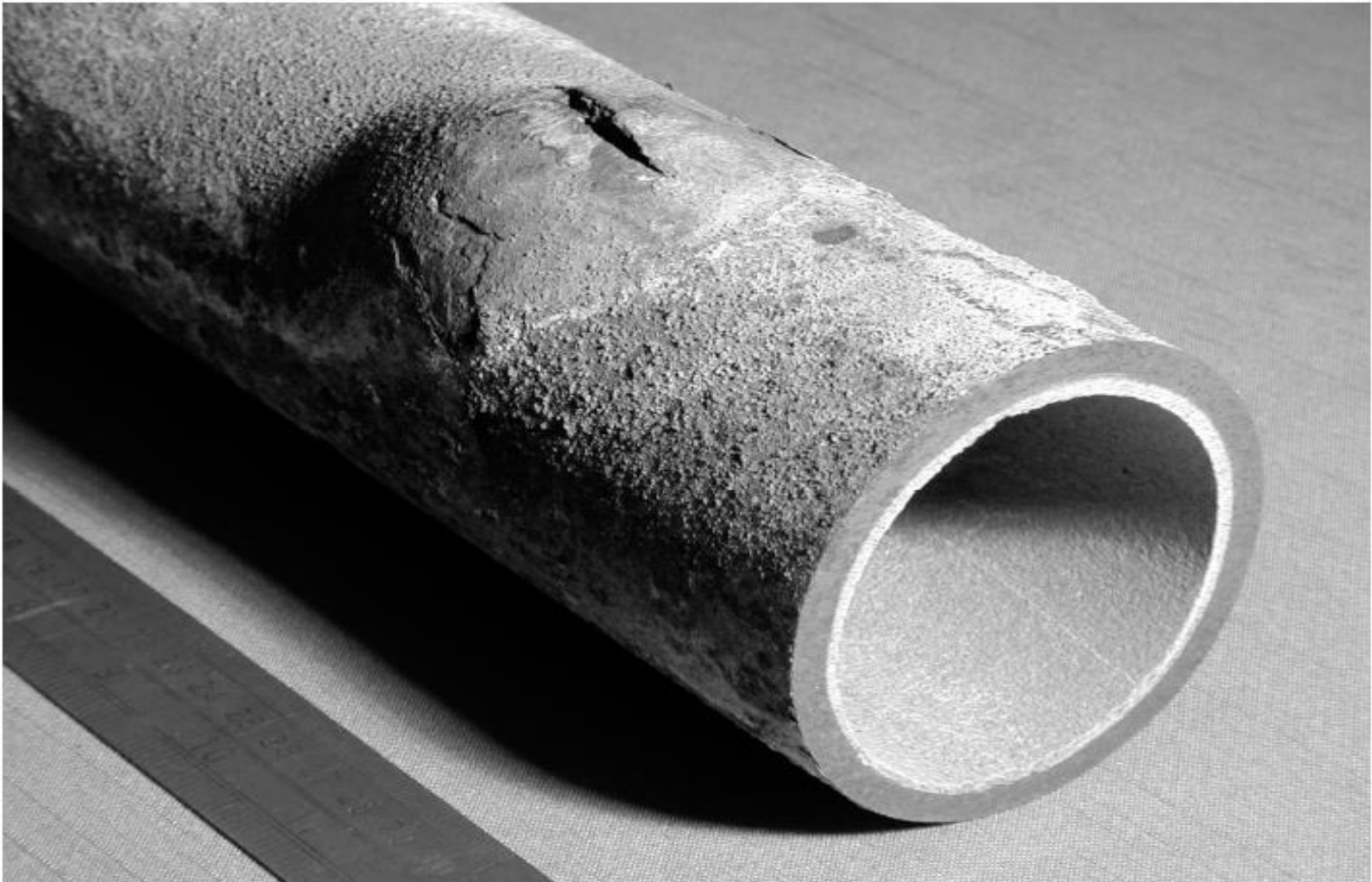
Figuur 21. Staal gaat door oververhitting kruipen en builen met scheurvorming als gevolg. (foto: S.
