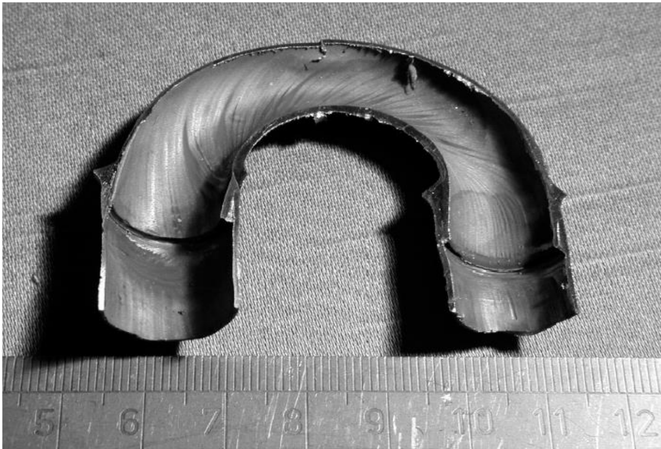
Figuur 3. De stroomsnelheden zijn normaal, maar door het corrosieve karakter van het getransporteerde hoog koolzuurhoudende bronwater is erosiecorrosie opgetreden. (foto: S. Vrijhoeven;
